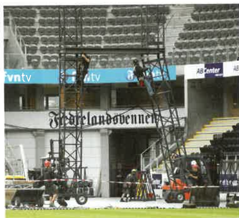
Denne porten var for lav og for smal, slik at utstyr fra 40 semitrailere måtte lastes om.
